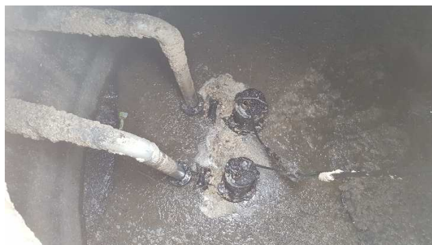
Pompownia ścieków orurowanie.
