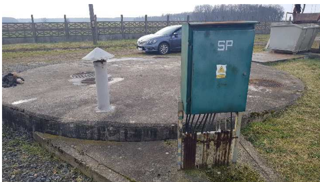
Pompownia ścieków z szafką zasilającą i sterowniczą.
